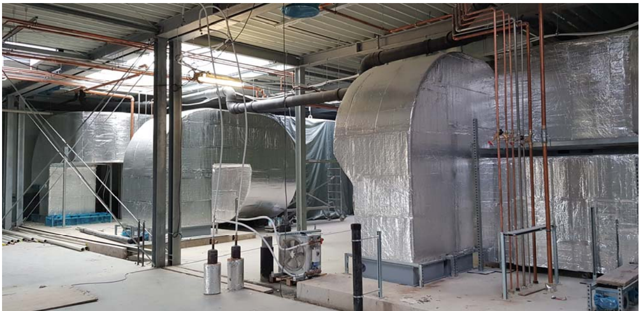
Bild 6 – Technikzentrale mit Zuluftanlagen
