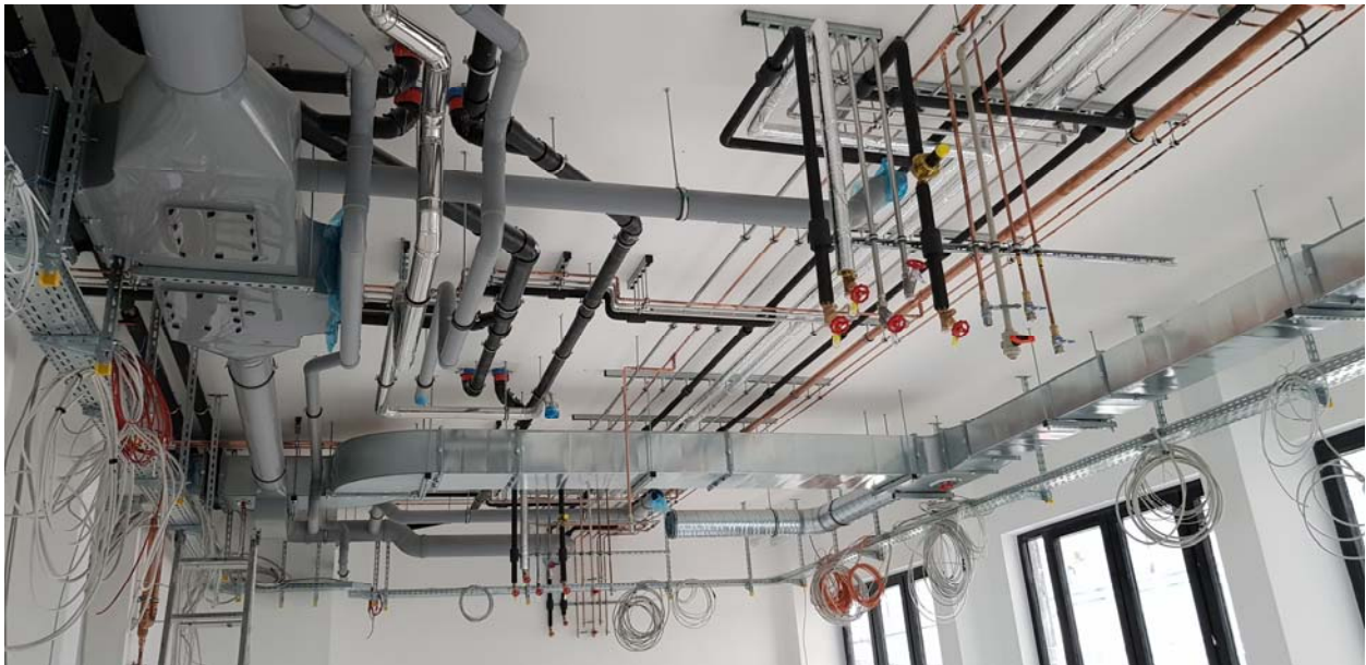
Bild 5 – Beispiel Deckeninstallation im Labor
